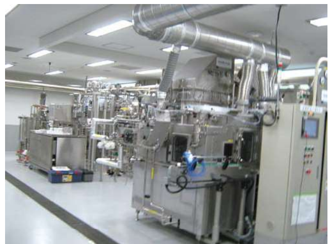
アセプティック充填施設 (設備制御盤側)
