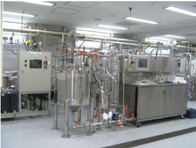
CIP/SIP施設とUHT殺菌機
