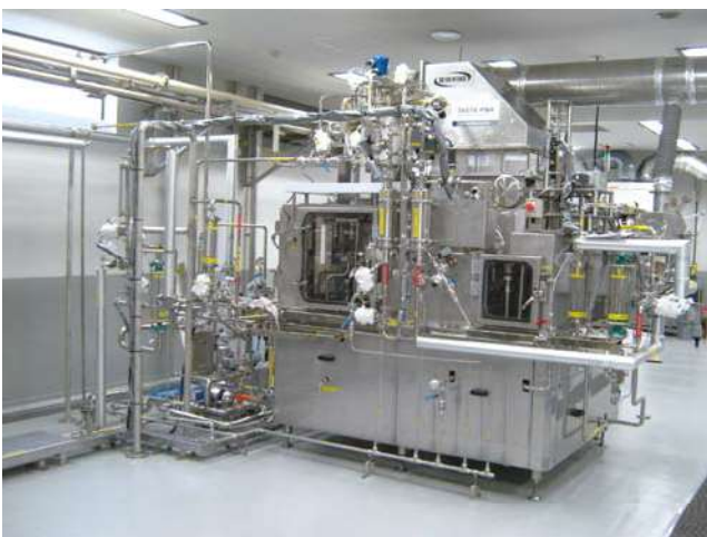
アセプティック充填施設 (充填サイド側)
